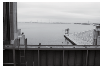
▲水門からは、海と川の水位が確認できます (水門から名古屋港方面を臨む)
