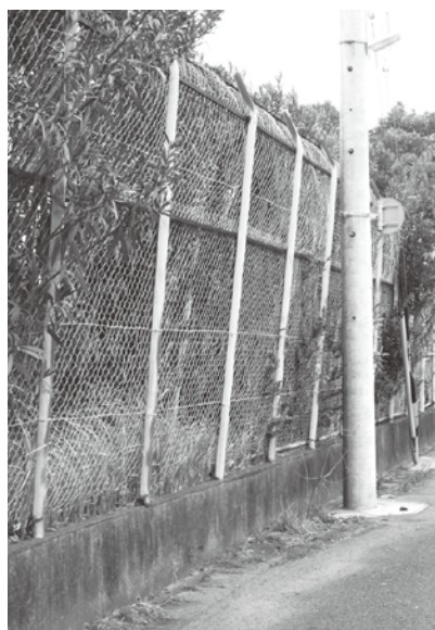
▲損傷の激しい蟹江高等学校跡地 北側敷地境界フェンス
