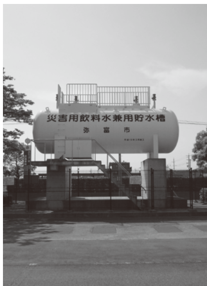
▲弥富市役所十四山支所に設置してある飲料水耐震タンク
