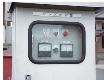
↑ この制御盤で排水ポンプを操作
