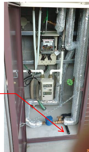
吸排気弁の放水先
