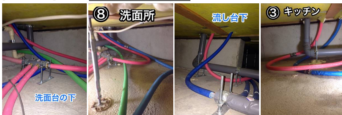
給水配管の支持が適切ではないため、ウォータハンマによる異音がおき、苦情が発生した例
