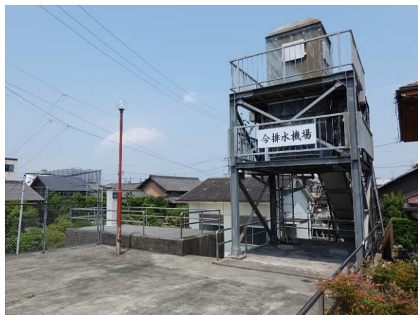
いまはいすいきじょう 今排水機場(城一丁目)
