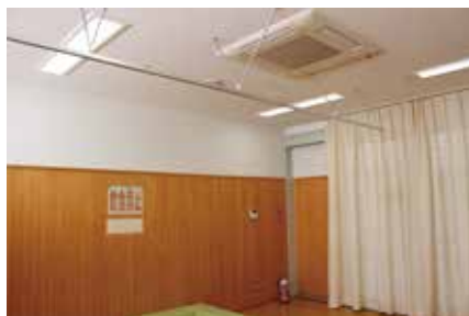
町体育館キッズルームの空調設備
