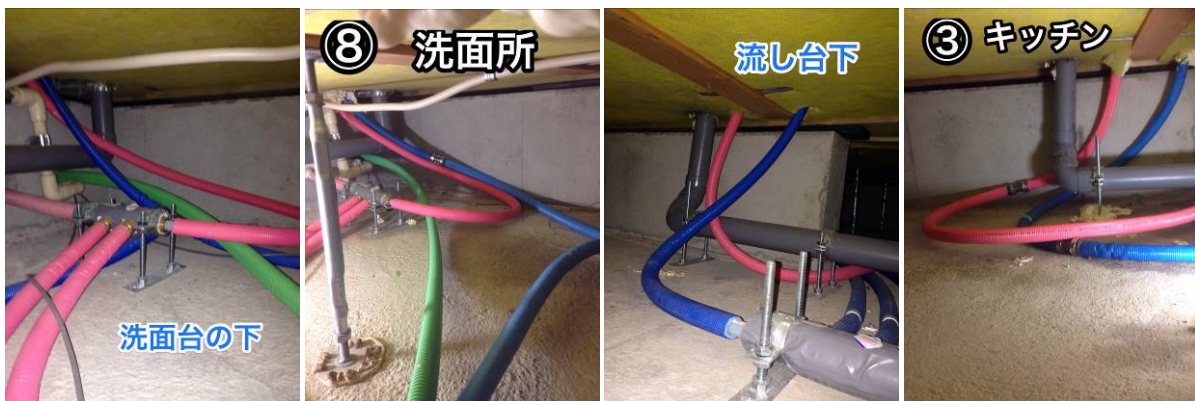
給水配管の支持が適切ではないため、ウォータハンマによる異音がおき、苦情が発生した例
