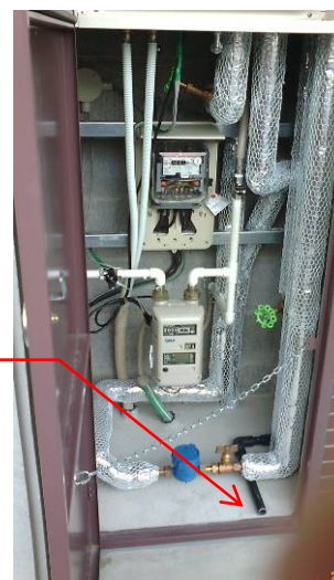
吸排気弁の放水先
