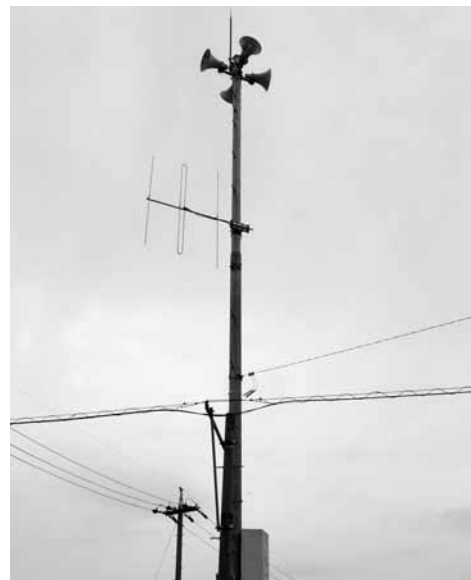
▲町内に設置してある同報無線
